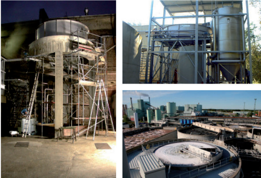
Abb. 8: Bisher installierte Systeme
