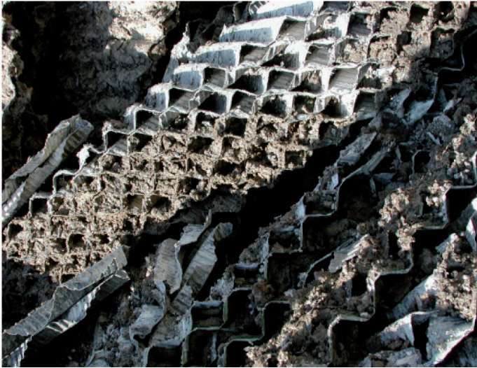
Abb. 1: Verstopftes Kühlelement eines offenen Abwasserkühlturmes
